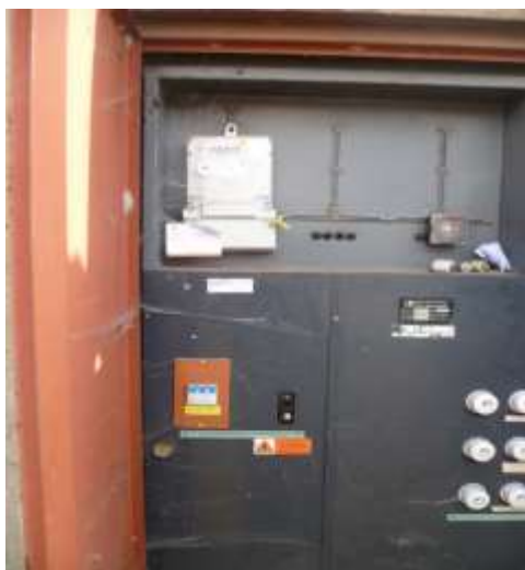
Rozvaděč - RV- 3a
