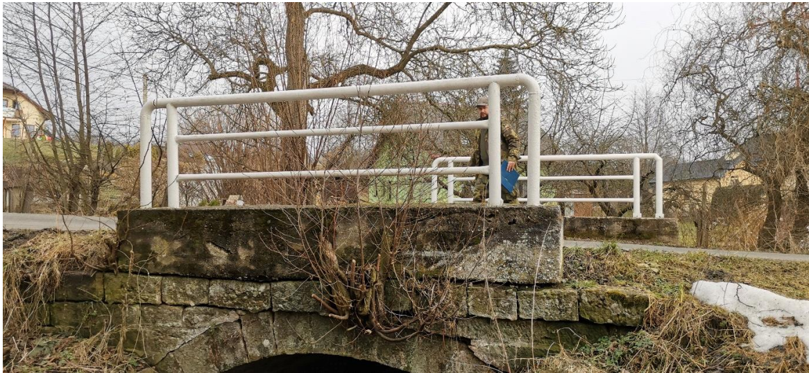
KAVERNA NA KŘÍDLE VTOKU
